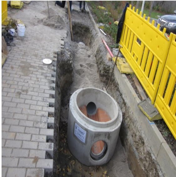
Anschluss des Entwässerungssystems Prager Straße an das Regenwassernetz im B-Plangebiet Tiroler Weg
